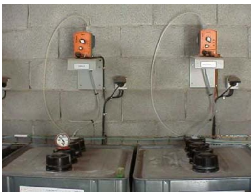
Bombas Dosificadoras Equipo de Tratamiento
