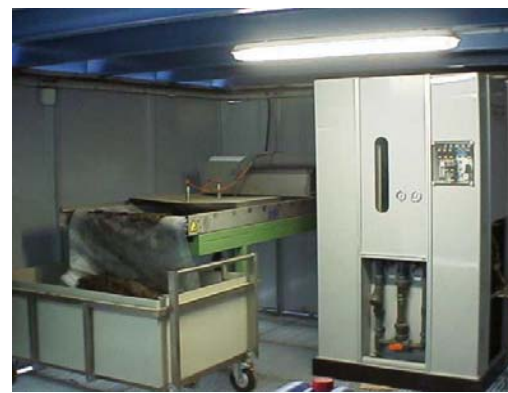
Equipo de Tratamiento y Filtro Banda para Lodos
