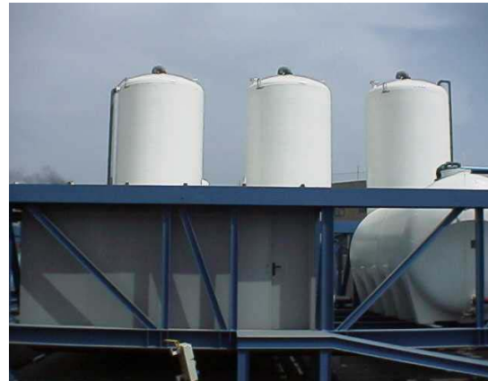
Caseta de Equipos de Tratamiento y Depósitos Acúmulo de Agua Tratada
