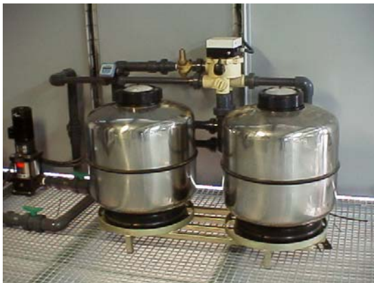
Sistema de Filtración para Aguas Tratadas Anterior al Acúmulo.
